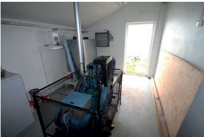
Under: Generator og inngang.
