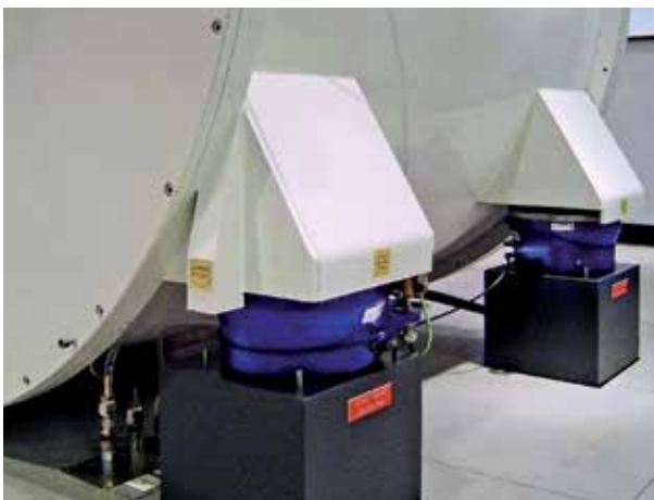
Beispiel Empfängerisolierung an einer Messmaschine
