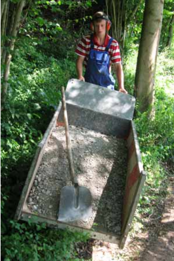
Abb. 19: Lars MASSMANN beim Wegebau für den grenzüberschreitenden Eco-Pfad am Schwiemelkopf bei Körbecke (Foto: D. KRÄMER)
