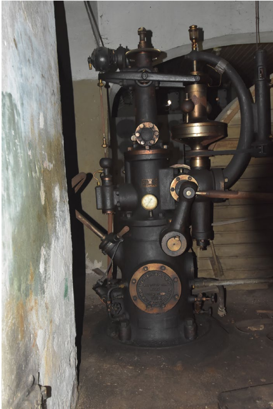
Turbinernas hastighet måste vara exakt rätt, de skovlar som viasdes på förra sidan öppnades och stängdes med denna automatiska turbinregulator som via hydraulik justerade mängden vatten som kom till turbinerna. Regulatorn är tillverkad av Verkstaden i Kristinehamn.
