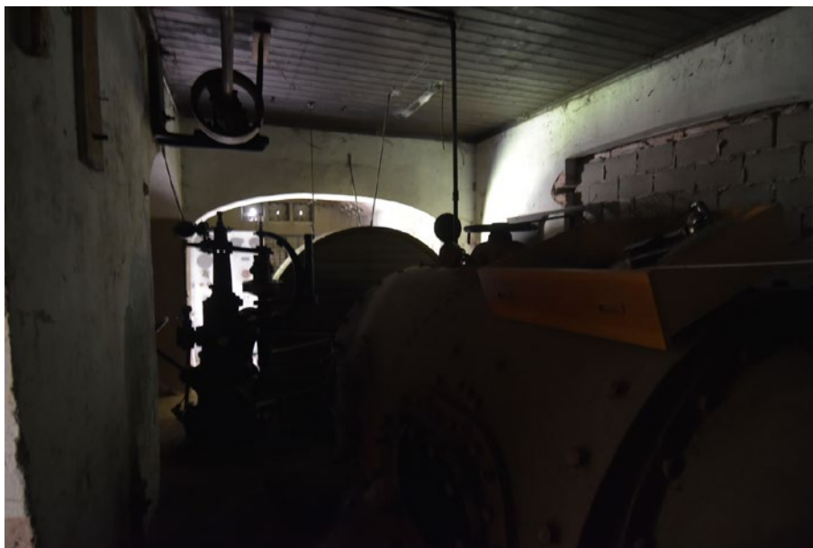
Turbinhallen från norr. Till höger tryckkammaren med turbinerna, bakom denna anas i motljuset turbinregulatorn, bakom denna inbyggnaden kring det stora svängjulet. Allra längst bak i fonden de tre luckorna där spänningen matades ut. 3-fas.
