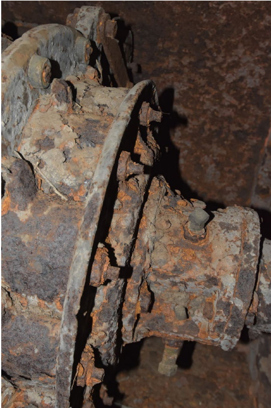
I tryckkammaren sitter två tvillingkopplade francisturbiner. Bilden visar pådraget med ledskovlarna till vänster och axelns lagring till höger.
