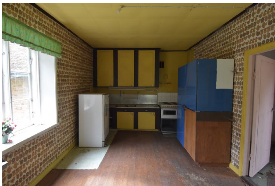
Köket, ett tidstypiskt rum med sina 1970-talskulörer på vitvaror och köksskåp. Inbyggt i köksinredningen finns dock äldre delar som mer pekar mot 1920-30-talet.
