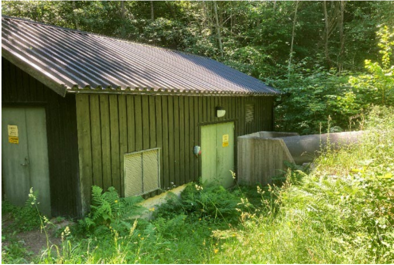
Figur 16. Baskarps kraftstation med tilloppstub.
