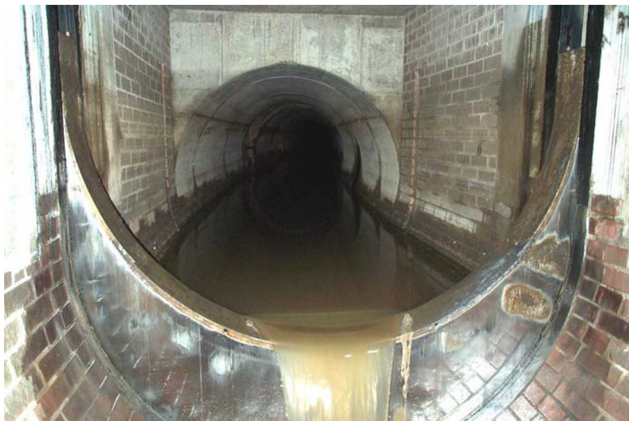
Bild A12: Versenkbares Wehr in einem Mischwasserkanal DN 2000
