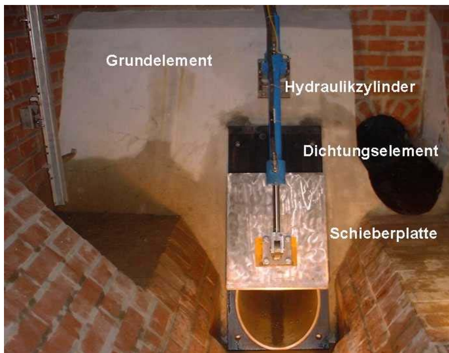
Bild A14: Schwall-Drossel-Schieber im Mischwasserkanal DN 600 der Stadt Mainz (ASA Technik, 2002)
