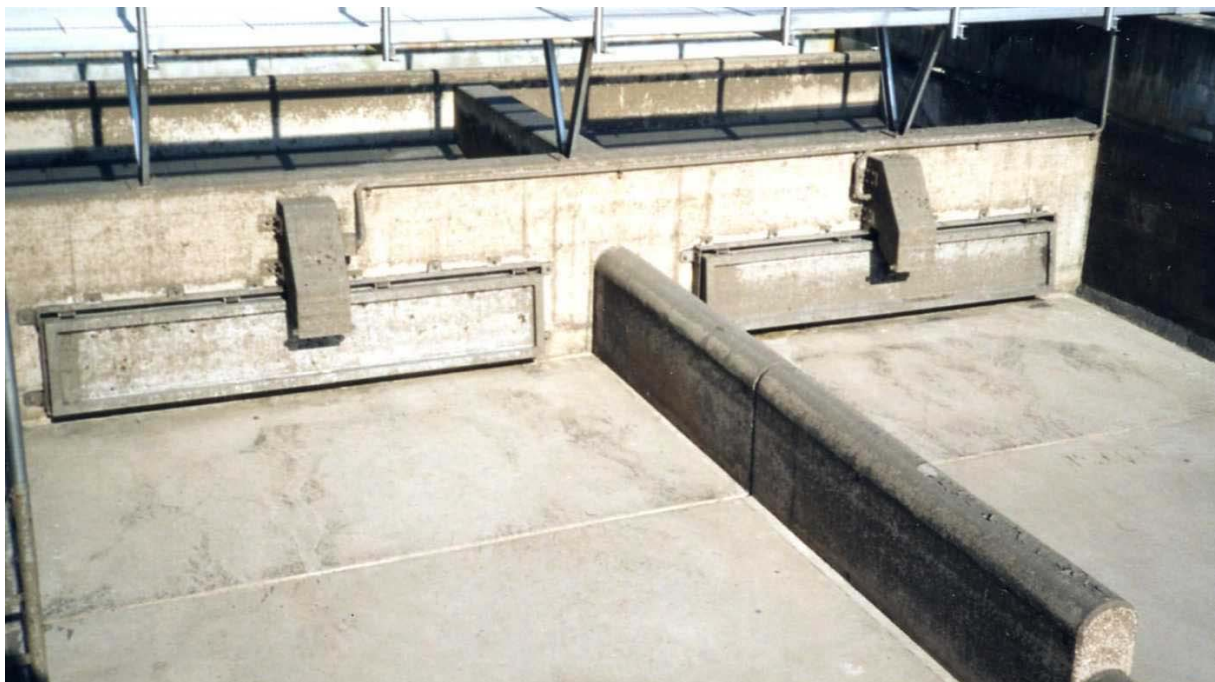
Bild A6: Kammer-Klappen-Anlage der Liwatech PG (LIEBAU, 2003)
