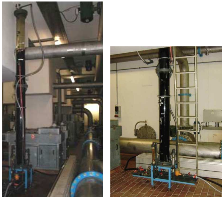
Abbildung 9 Filtersäule des KA mit Aktivkohle
