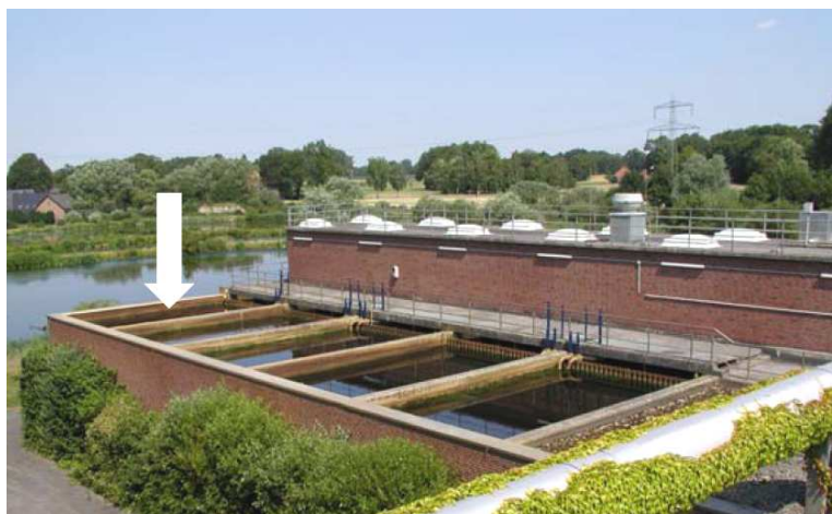
Abbildung 5 Blick auf die (halbe) Biofor-Flockungsfiltrationsstufe des AOL mit umgerüsteten Adsorber (Pfeil)
