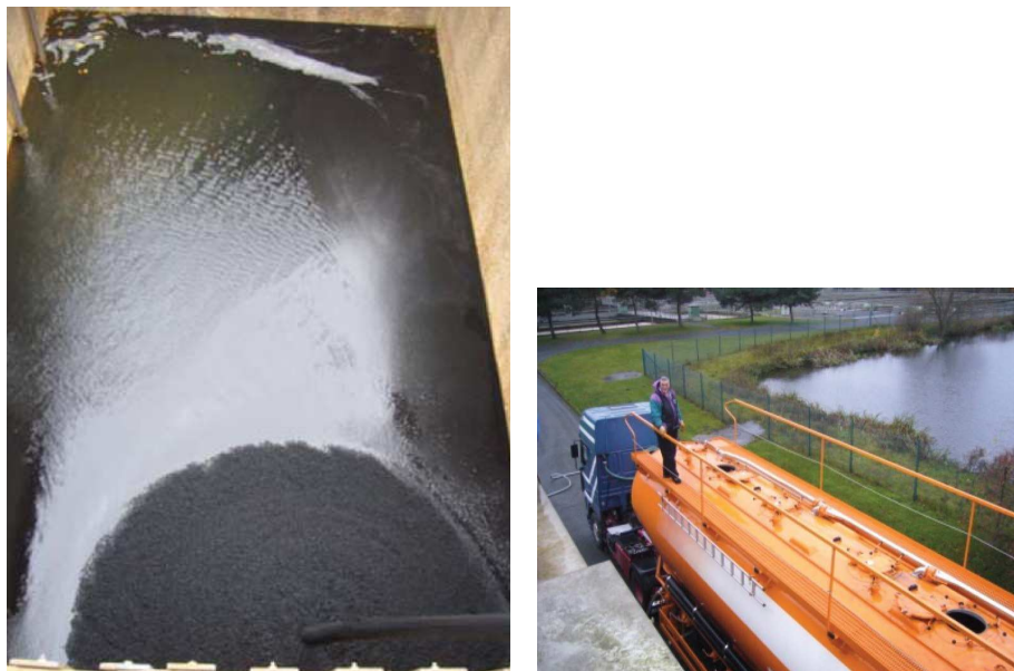
Abbildung 7 Blick in den GA (links) während der Befüllung mit Aktivkohle durch einen Silotransporter (rechts)
