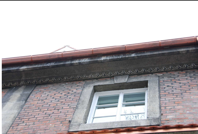
5 Ersatznistplätze an der Stelle der ursprünglichen Niststellen
