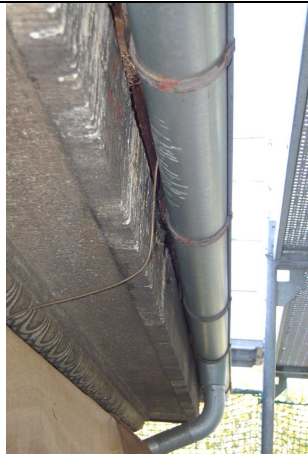
1 Kotsuren an der Rinnenunterseite
