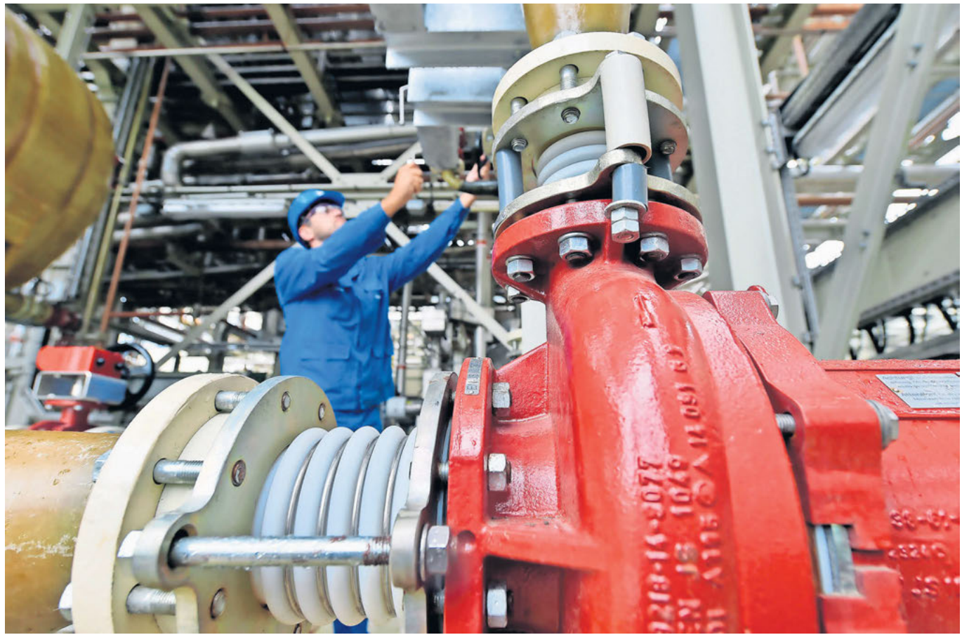
Ein Mitarbeiter des Chemieunternehmens Nouryon in Bitterfeld-Wolfen arbeitet an einer Anlage. Nouryon stellt vor allem Chlor her.
