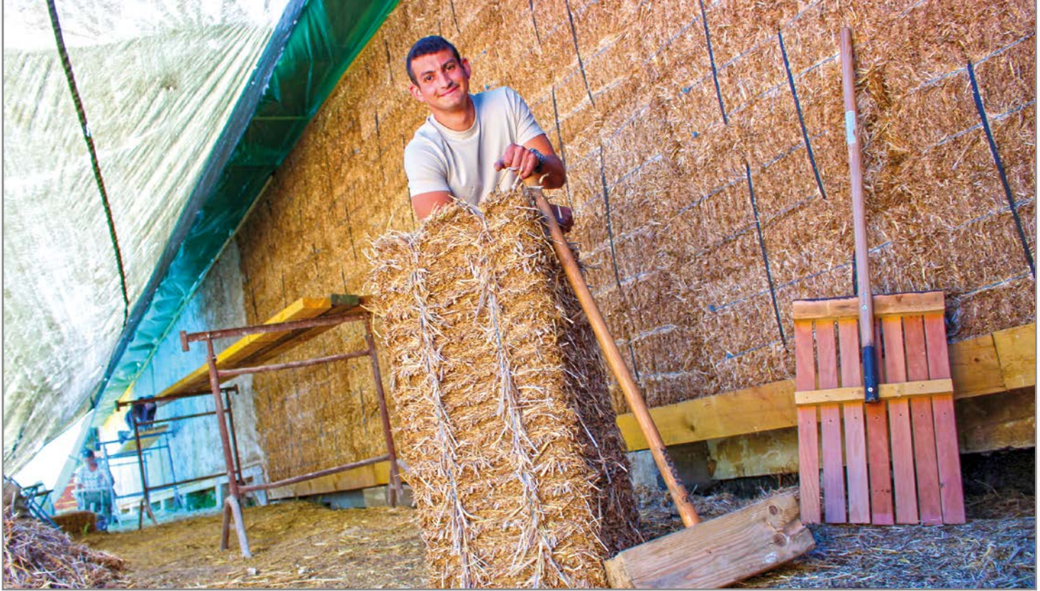
À Crécy-au-Mont, à 15 km au nord de Soissons, Sami Houem rénove entièrement une ancienne bergerie. Il isole ainsi toute une façade de 170 m 2 en paille porteuse.
