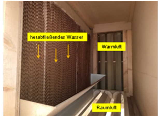
Abb.: Kühlpad zum Einstellen der richtigen Belüftungsluft
