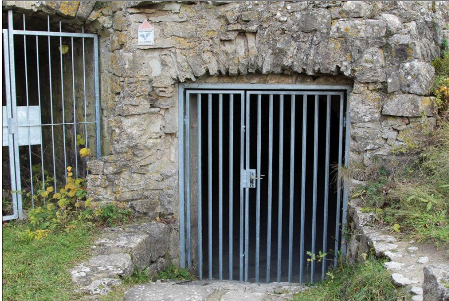
Abb. 40: Eingang eines der Gewölbe in der Hauptburg der Ruine Homburg (Foto: M. HAMMER 26.11.2017)
