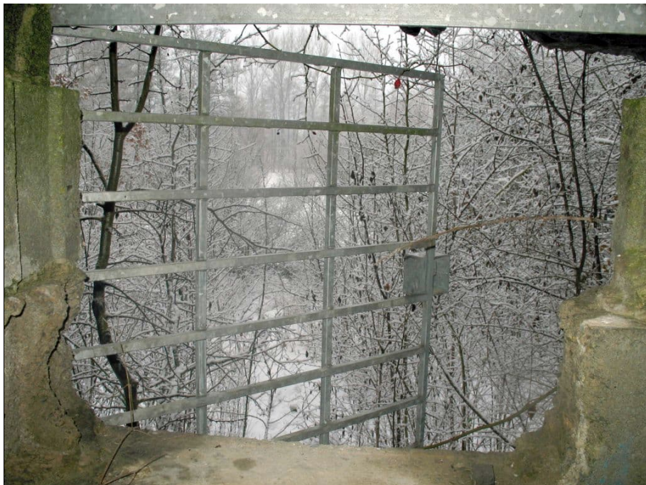
Abb. 41: Vergitterung des Fledermausstollens (Foto: M. HAMMER 24.12.2010)
