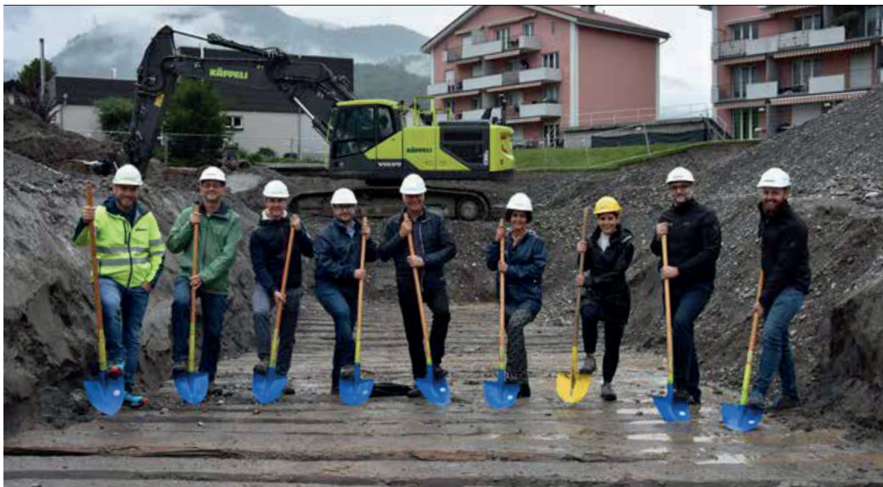
Stehen fürs Foto schon in der Baugrube: Jürg Thöny (Käppeli AG), Benno Lutz (Liesch Ingenieure AG), Patrick Bless (Kopp und Ackermann AG), Simon Meyer, Melchior Vogler und Patrizia Wachter Tanner (alle Prefera Immobilien AG), Christine Schöb (Schöb AG) sowie Roberto Manzella und Raphael Rüegg (Atelier drü) freuen sich über einen spannenden Bau im Herzen von Mels.
