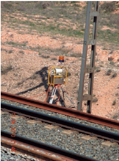
Imagen 5.6. Sistema Automático de Alarma por Aproximación de Trenes (SAAT). Fuente: COMSA
