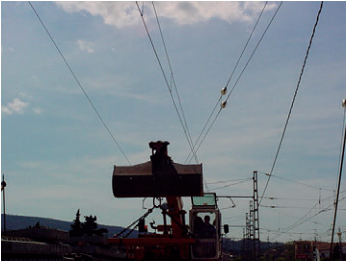
Imagen 6.12. Máquina junto a línea eléctrica aérea. Fuente: VIAS
