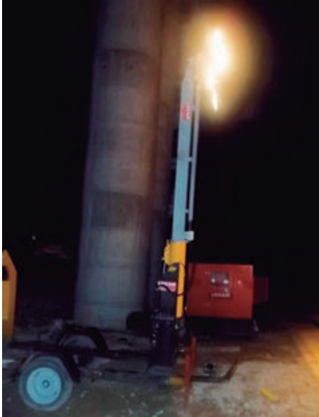
Imagen 3.29. Torre de iluminación. Fuente: VIAS
