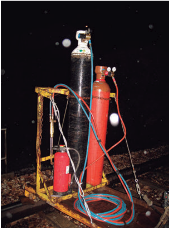
Imagen 3.21. Botellas de acetileno para soldadura. Fuente: COMSA
