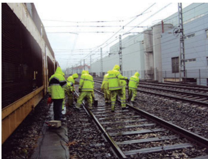
Imagen 3.14. Trabajos con riesgo de arrollamiento. Fuente: TECSA
