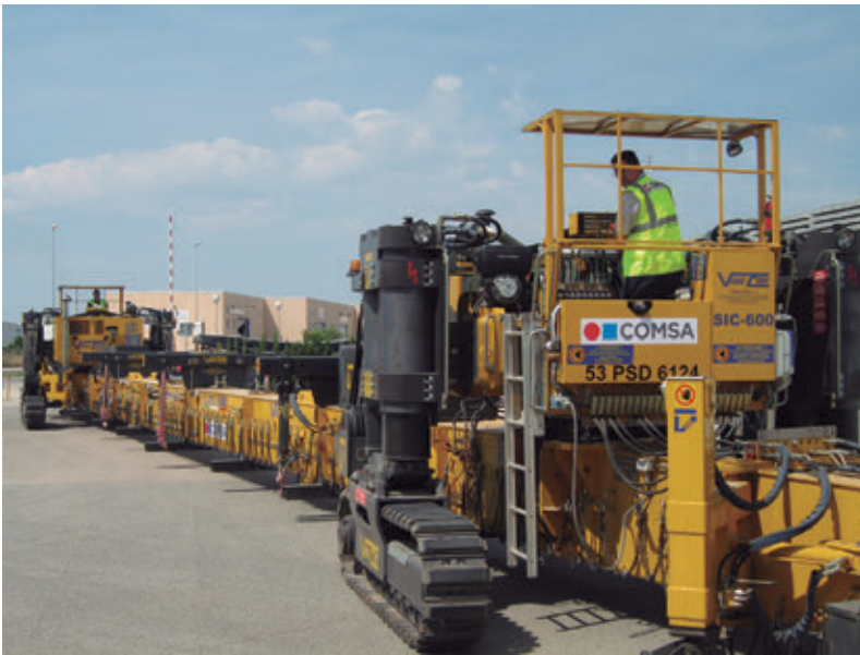
Imagen 2.25. Pórtico de cambio de desvíos. Fuente: COMSA
