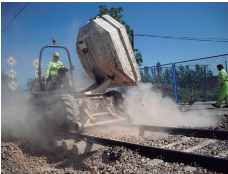
Imagen 3.27. Polvo por vertido de balasto. Fuente: TECSA
