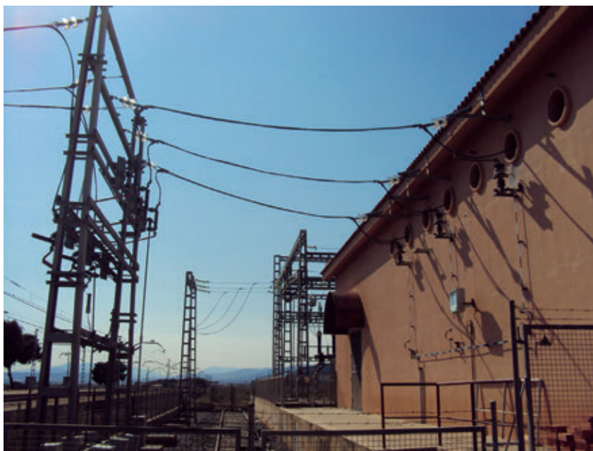
Imagen 6.1. Subestación eléctrica. Fuente: VIAS
