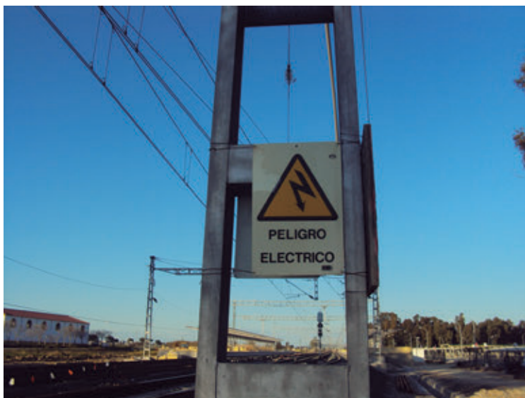
Imagen 6.10. Señalización de riesgo eléctrico. Fuente: COMSA
