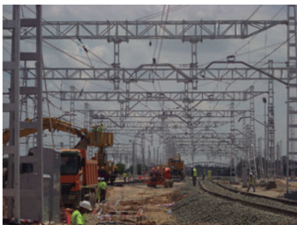
Imagen 5.2. Interferencias de actividades y concurrencia de maquinaria. Fuente: TECSA
