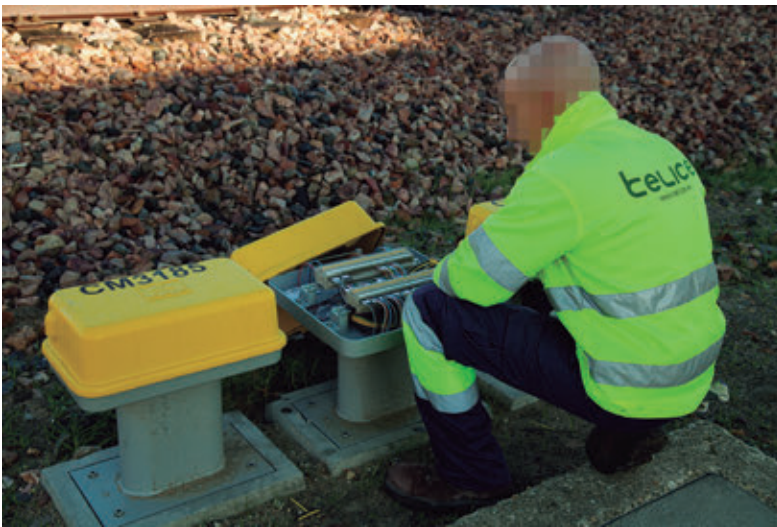
Imagen 6.3. Instalaciones a pie de vía. Fuente: TELICE
