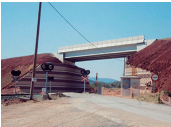
Imagen 5.11. Interferencia de los trabajos de ejecución de un paso a nivel con vía férrea en servicio. Fuente: VIAS
