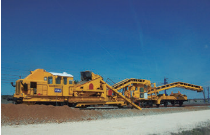
Imagen 2.4. Desguarnecido de la vía sobre la banqueta. Fuente: VIAS
