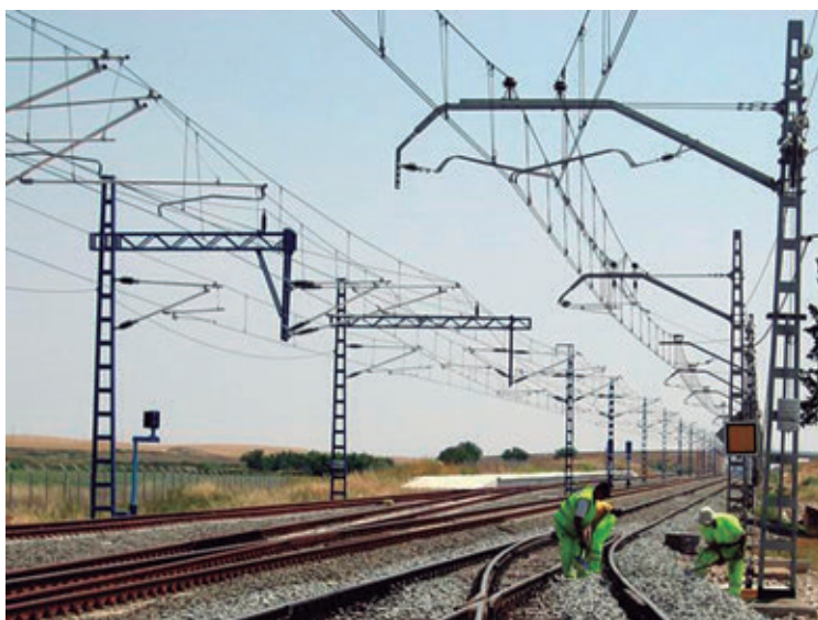
Imagen 6.6. Línea aérea de contacto. Fuente: COMSA
