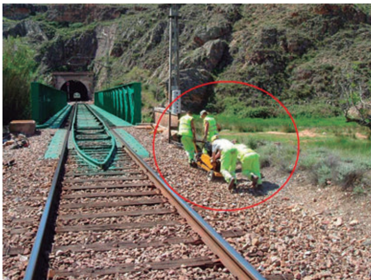
Imagen 5.7. Riesgo de arrollamiento. Fuente: COMSA
