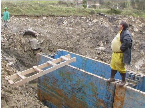
Imagen 20. Actos inseguros Acceso al interior de la entibación sin las escaleras adecuadas.
