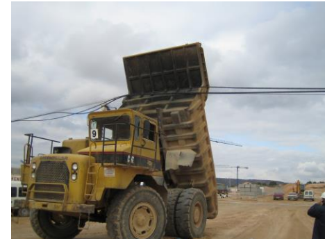
Imagen 2. Interferencia con tendidos eléctricos aéreos.
