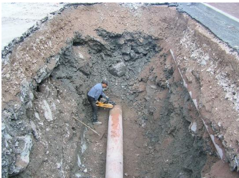
Imagen 27. Trabajador dentro de una zanja sin entibar.
