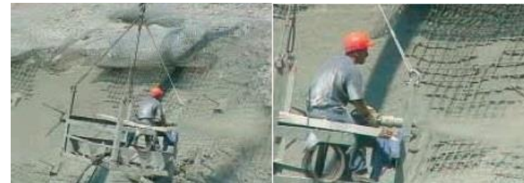
Imagen 7. Trabajador situado en la barandilla de la plataforma. Algo PROHIBIDO.
