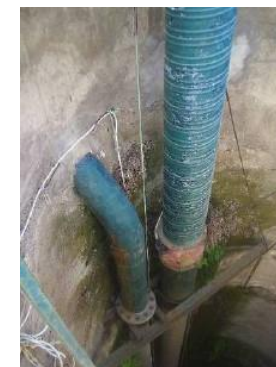
Imagen 12. Tubería de ventilación en un pozo.
