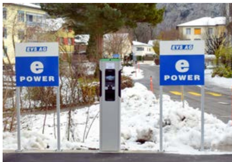
Umgerüstete Ladestation für Elektrofahrzeuge an der Oberbirgstrasse.
