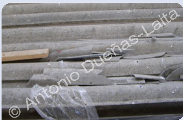
Figura 1. Material de construcción con fibra de amianto.
