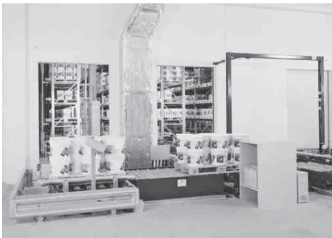
Bild 2: Zusätzlich wurden die Schaltschränke für die Palettenfördertechnik (HOFA) und den Verschiebewagen (VW) umgebaut.
