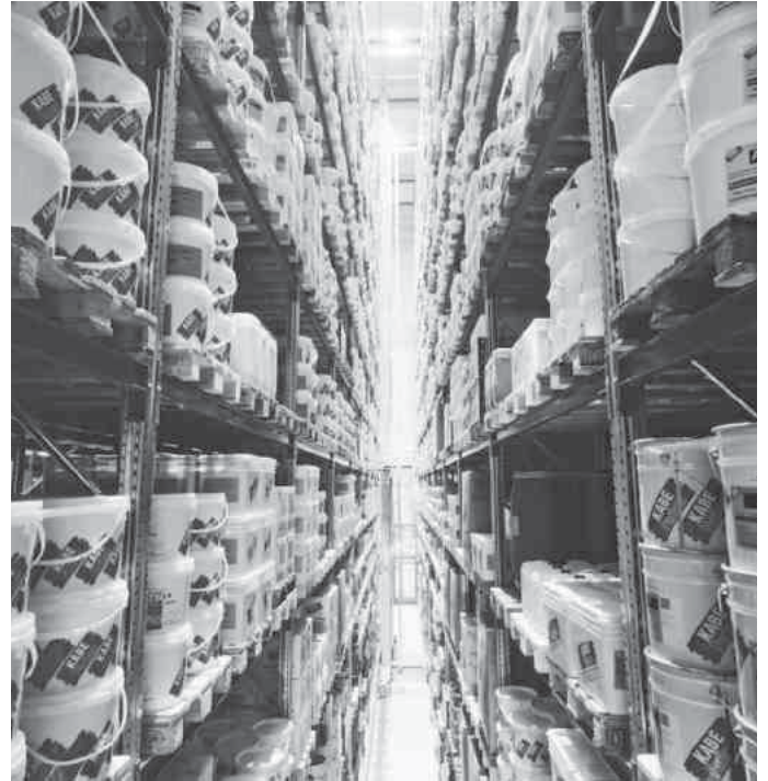
Bild 3: Durch die Modernisierungsmassnahmen konnte die Betriebssicherheit bei der Karl Bubenhofer AG verbessert und die Anlagenverfügbarkeit deutlich erhöht werden.
