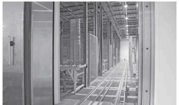
Als Brandschutzvorkehrung wurde im HRL eine Inertisierungsanlage mit Barrieren zur Vorzonen-Fördertechnik errichtet.
