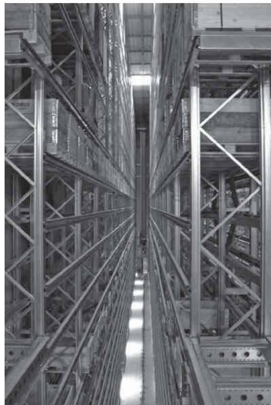
Abb. 4: Ein Blick in ein Hochregallager mit einem Paletten-RBG bei Hans Kohler AG. Quelle: agiplan/Stöcklin
