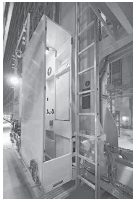
Zugang zur Notsteuerkabine.
