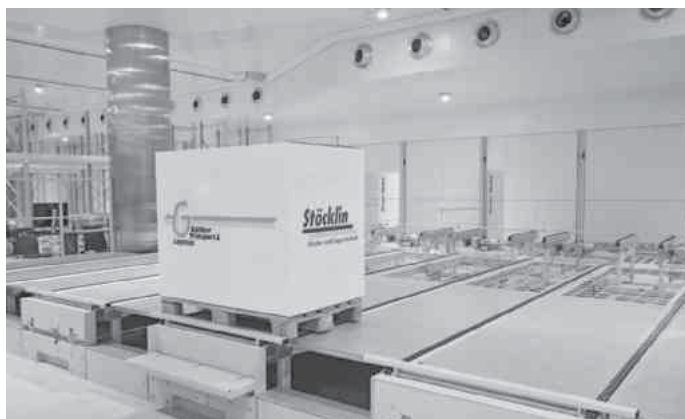
Die Gestaltung der Kommissionierplätze hat in Sachen Ergonomie und Sicherheit Vorzeigecharakter.
