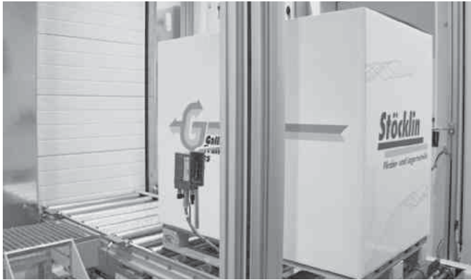
Im Zuge der Vereinnahmung werden die angelieferten Paletten auf Rollenbahnen aufgesetzt und der Profilkontrolle mittels fest installierten Scannern zugeführt.
