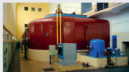
Generátor ve strojovně průtočné elektrárny [zdroj: ČEZ a.s.]
