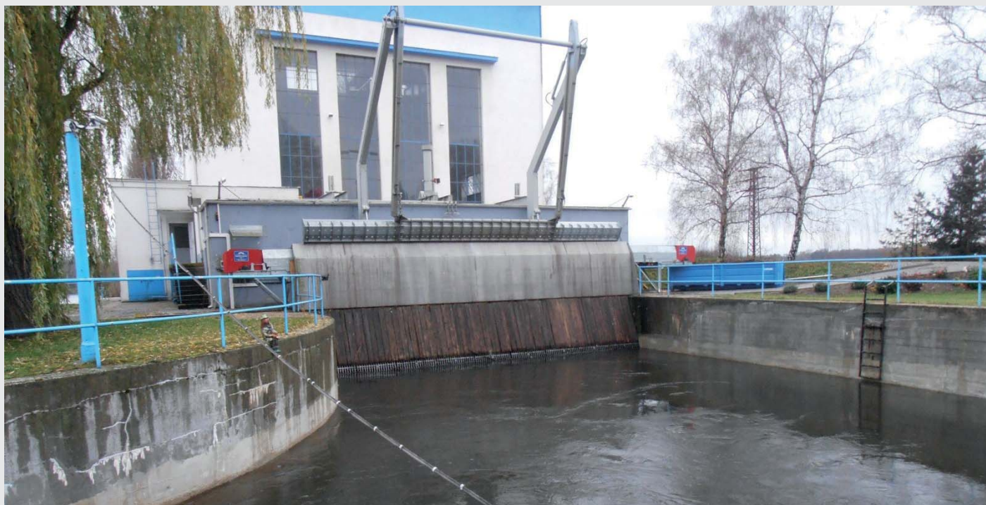
Vtok do MVE a jemné česle – pohled z hrubých česlí (zdroj: Povodí Labe, státní podnik)
