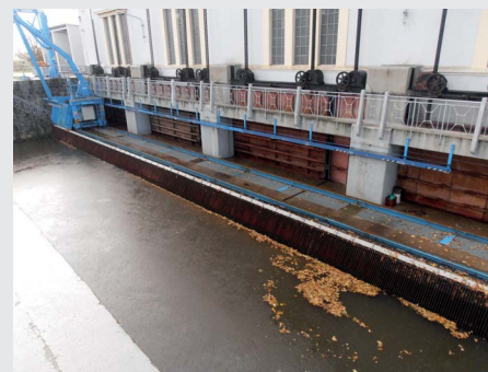
Pohled na vtoky do MVE a česle MVE (zdroj: Povodí Labe, státní podnik)
