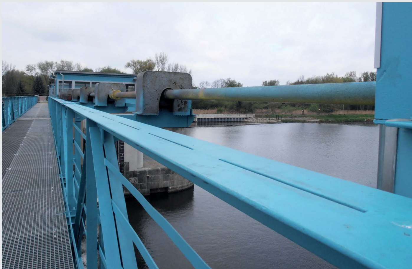
Transmisní hřídel (pohon) umístěný na jezové lávce (zdroj: Povodí Labe, státní podnik)
