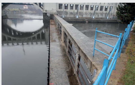
Pohled na hrubé česle na vtoku MVE (zdroj: Povodí Labe, státní podnik)
