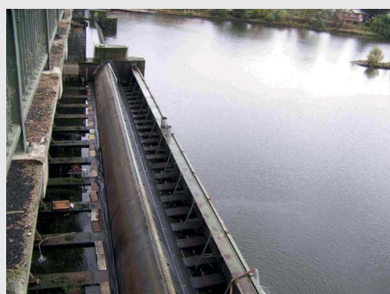
Hradicí konstrukce – sektor s provizorním zahrazením z důvodu opravy (zdroj: Povodí Labe, státní podnik)
