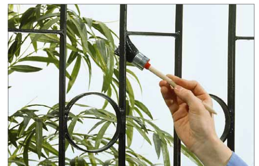
6 Der Endanstrich erfolgt wieder mit dem Metallschutzlack. Diese Lacke gibt es in unterschiedlichen Farben
