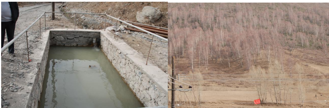
废水沉淀处理
