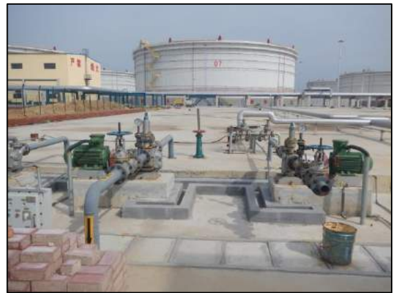
事故池及雨水收集池
