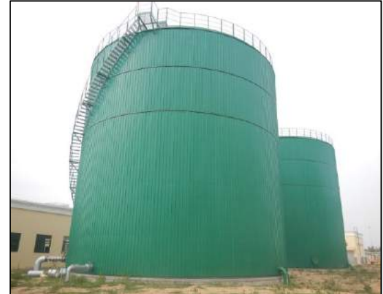
消防泵房及消防水罐
