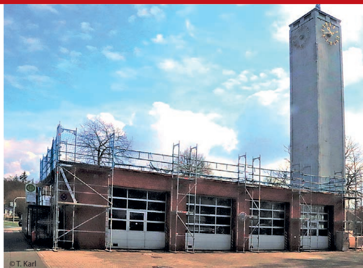
Ein Gerüst als Absturzsicherung reicht rund um die Fahrzeughalle, aber alle Ausfahrten der Feuerwehrfahrzeuge sind freigehalten.
