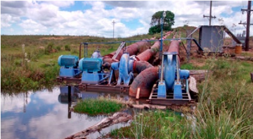
Figura N° 9. Toma de agua en una arrocera. Municipio La Cruz. Año 2014
