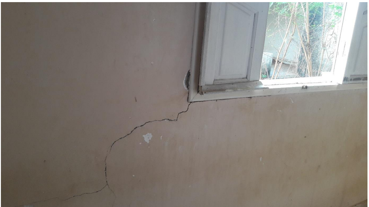
CASA DO REASSENTAMENTO CONSTRUÍDO EM 2005, DESOCUPADA HÁ 02 ANOS POR CONTA DAS RACHADURAS
