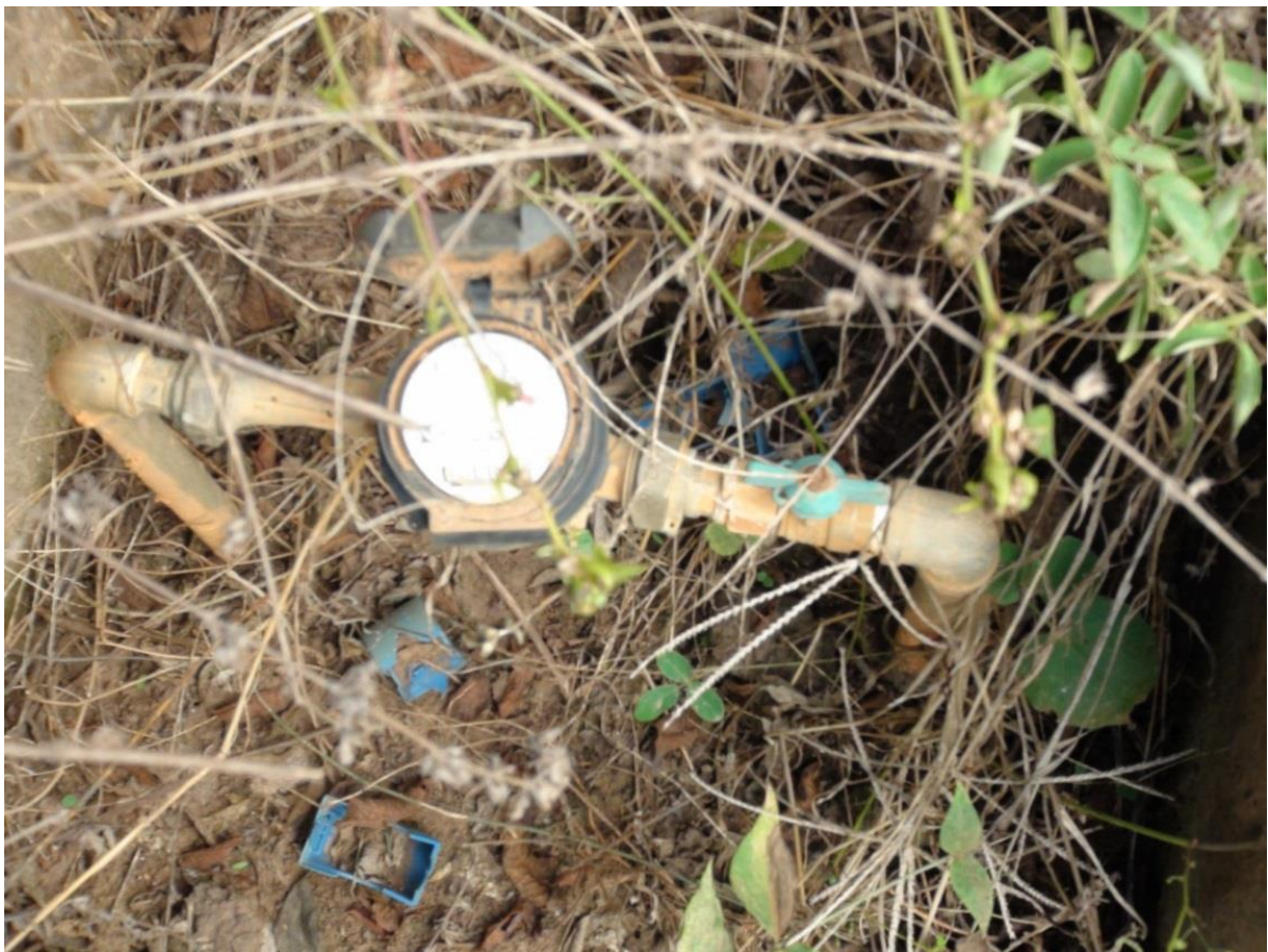
HIDRÔMETRO SEM FUNCIONAMENTO NA AGROVILA II
