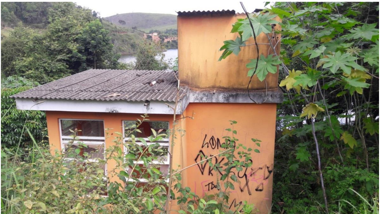
ESTAÇÃO DE TRATAMENTO DE ESGOTO – ETE INOPERANTE
