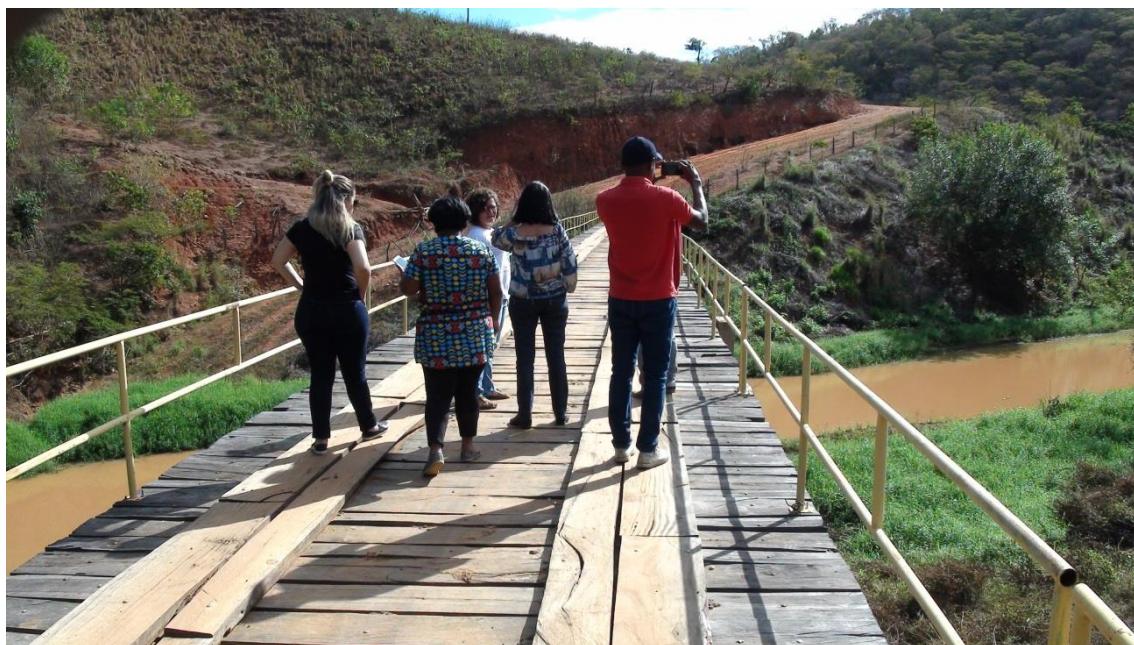
PONTE REFORMADA PELOS MORADORES - RIBEIRÃO DO GRANJAS
