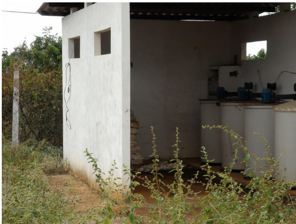
ESTAÇÃO DE TRATAMENTO DE ÁGUA. MATERIAL DETERIORANDO
