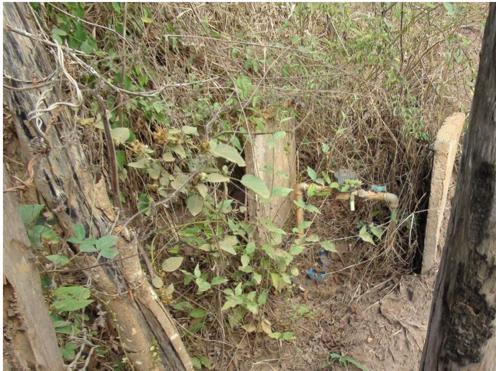
HIDRÔMETRO SEM FUNCIONAMENTO NA AGROVILA II
