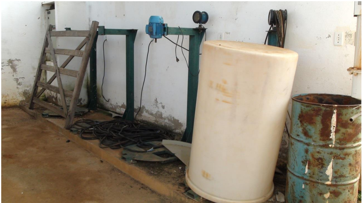
MATERIAL DETERIORANDO NA ESTAÇÃO DE TRATAMENTO DE ÁGUA – AGROVILA II
