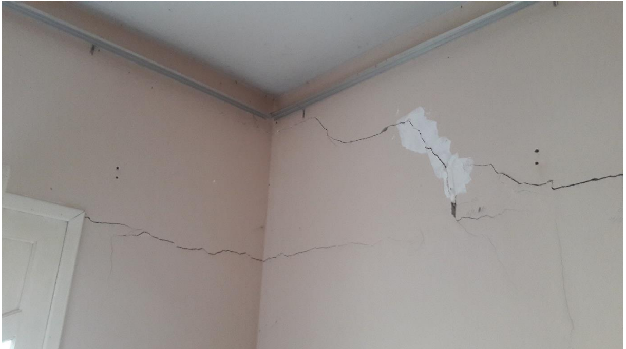
CASA DO REASSENTAMENTO CONSTRUÍDO EM 2005, DESOCUPADA HÁ 02 ANOS POR CONTA DAS RACHADURAS
