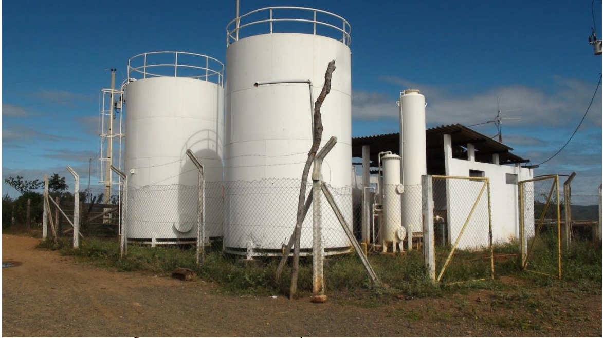
ESTAÇÃO DE TRATAMENTO DE ÁGUA INOPERANTE - AGROVILA II
