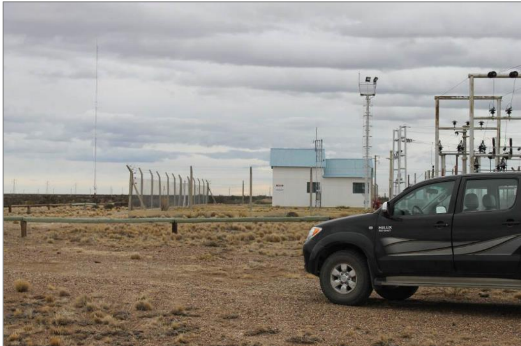
Foto 16. Transecta G, estación transformadora.
