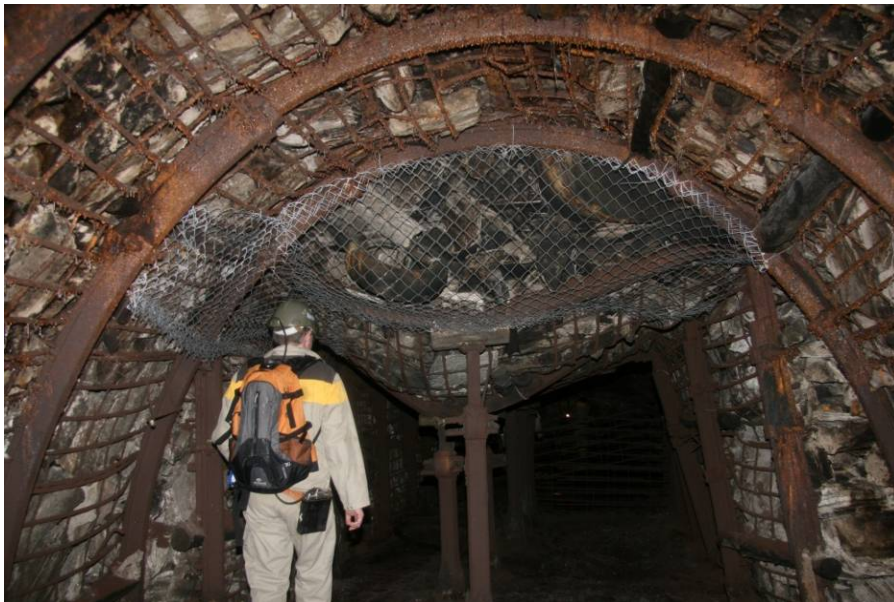
Figure 26 : Chutes de toit (instabilité locale), Mine de calcaires asphaltique, Gard (Source : INERIS).
