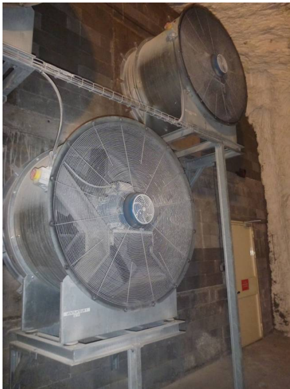
Figure 14 : Ventilateurs principaux couplés en carrière souterraine, Isère (Source : INERIS, SAMIN).
