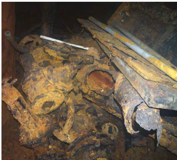
Valamikor még szolgáltak valamire ezek a csövek
