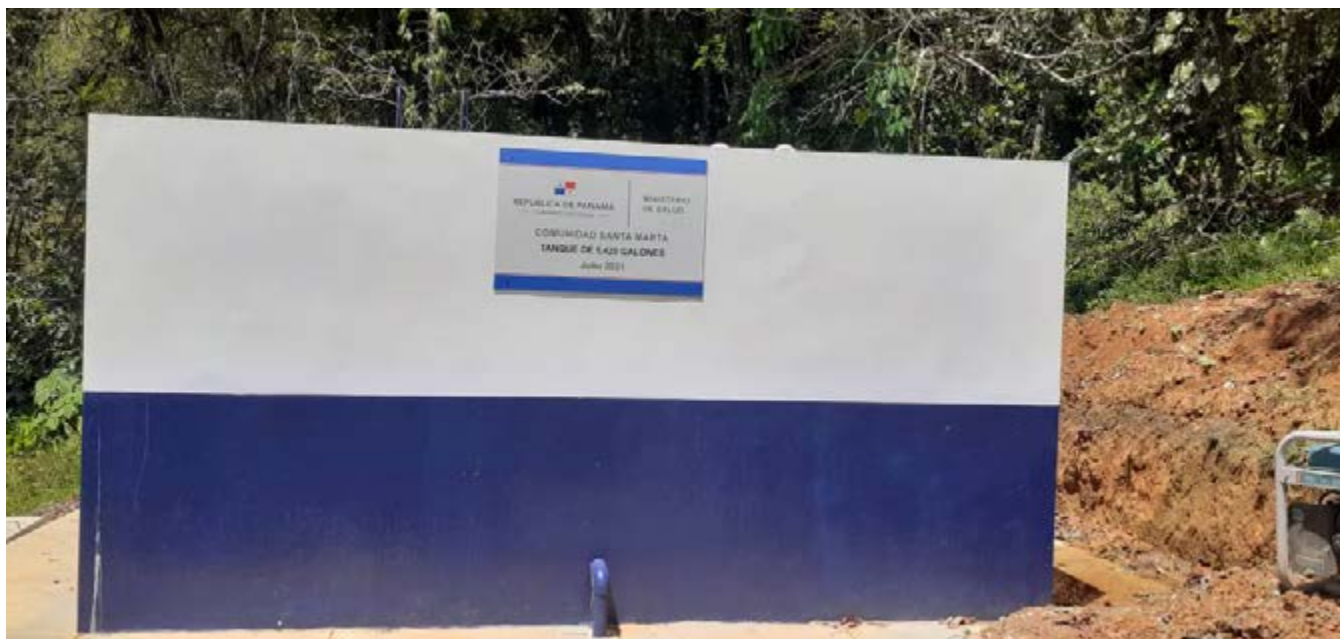
Tanque de Almacenamiento Comunidad de Santa Marta Bocas Del Toro.
