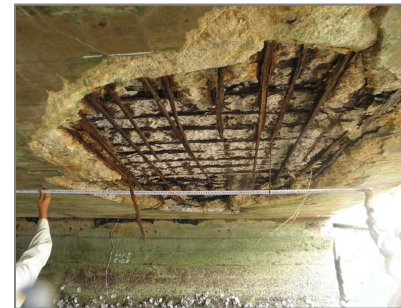
床版鉄筋露出
