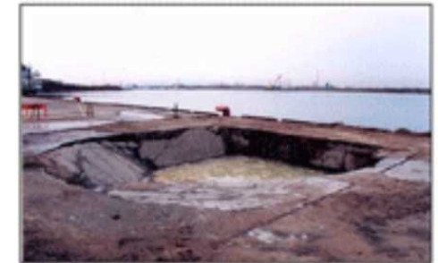
港湾施設エプロン部分の陥没
