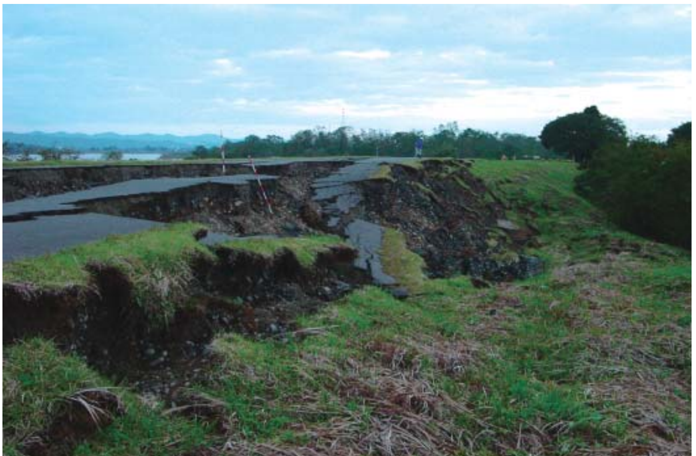
▼地震によって崩れた信濃川の堤防（長岡市三俣野町）〔写真提供／北陸地方整備局〕
