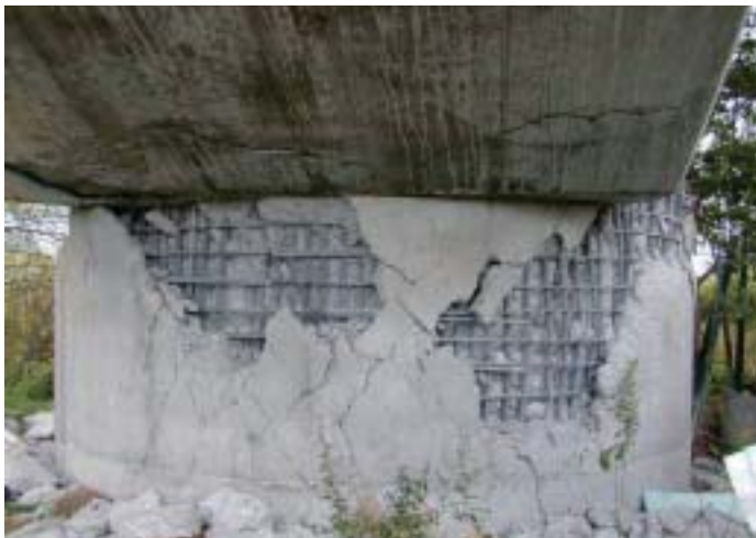
◀国道17号小千谷大橋の橋脚コンクリート剥落 〔写真提供／北陸地方整備局〕
