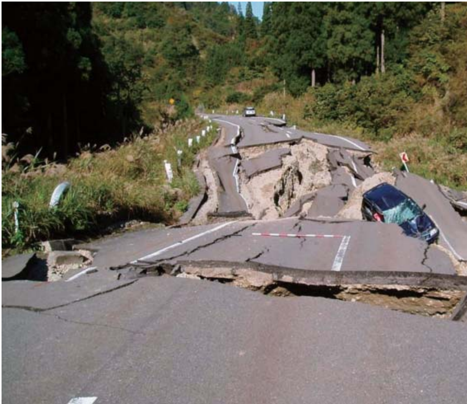
▲陥没した国道252号（旧堀之内上稲倉）〔写真提供／新潟県土木部〕
