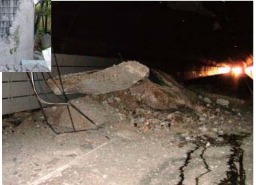
▲国道17号和南津トンネルのコンクリート剥落〔写真提供／北陸地方整備局〕
