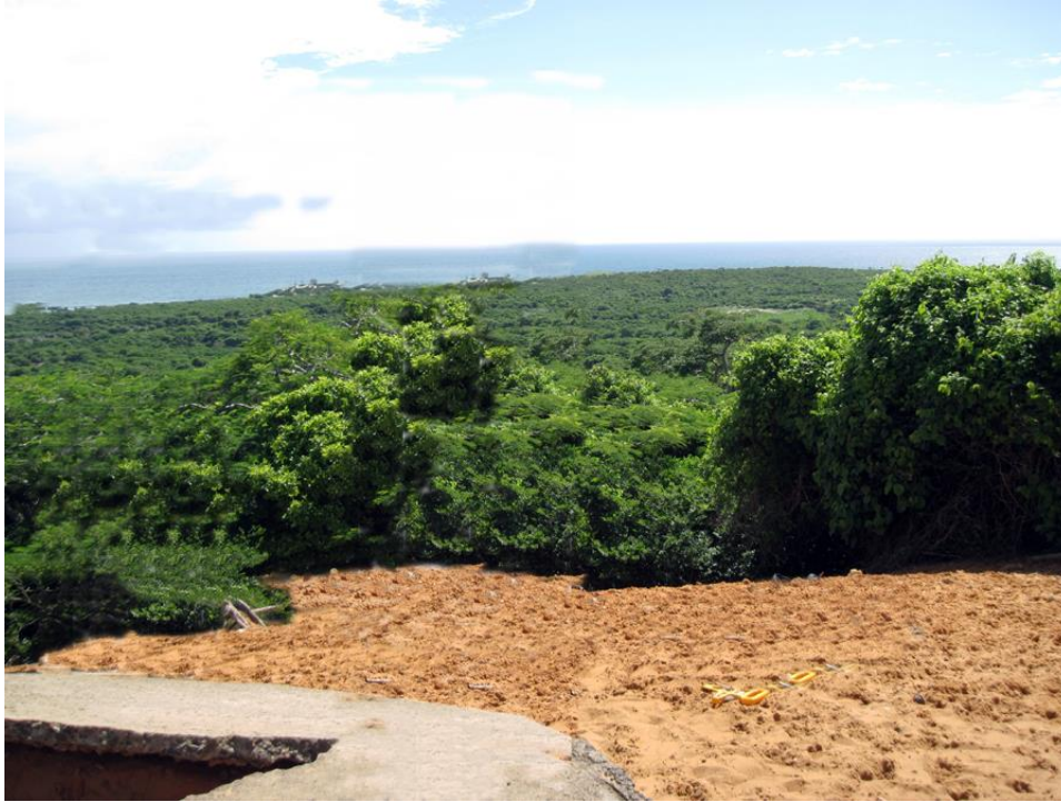
Figure 9 : Au premier plan la partie très dégradée et au deuxième plan le noyau dur
