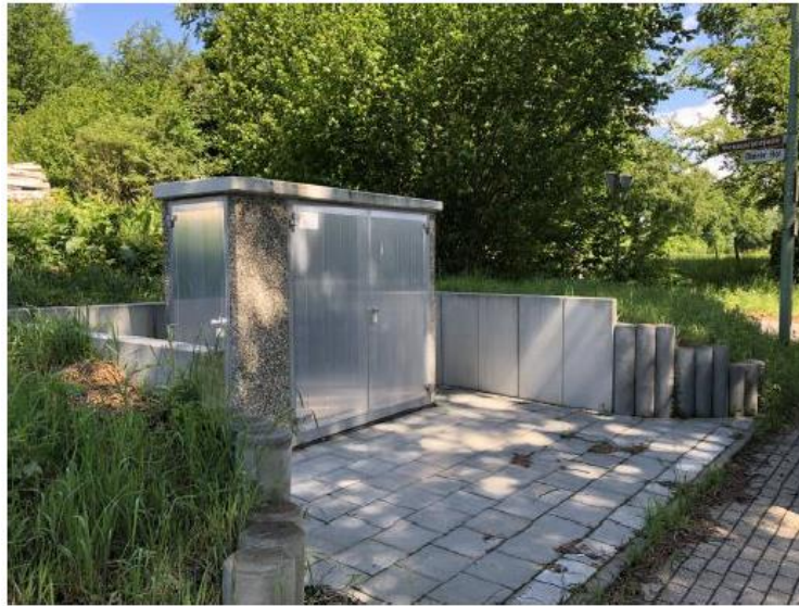
Gasversorgungsanlage am Kirschensteinweg (Quelle: H. Berg & Partner GmbH)
