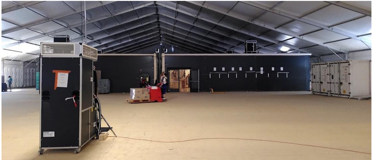
Foto 42: Blick in die (leere) Verpflegungszentrale mit Rückkühler im Vordergrund und Kühlhalle (mit schwarzen Panelen isoliert) (Mischa Kaspar / Monti)
