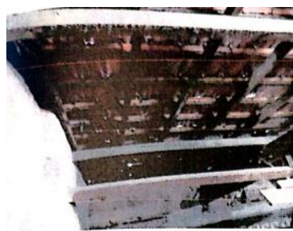
Foto 32 e 33. Telhado Nave Principal – Frestas nas telhas.
