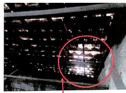
Telhas desalinhas e mal substituídas
