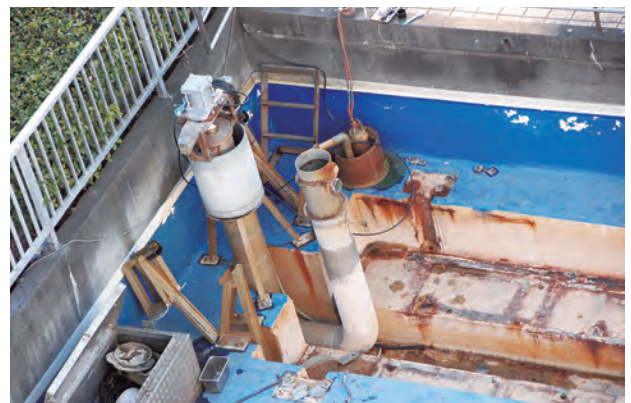
写真2 排気用パイプ
