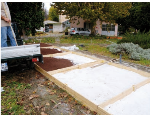
Figura 1: Allestimento del tetto verde simulato a terra mediante idroperlite (materiale bianco sottostante) ed agriterram (substrato commerciale ideato per giardini pensili).
