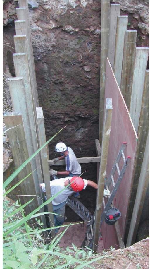
Construction d'une fosse de 10 m de profondeur pour étudier la dynamique de l'eau dans un sol andique des hauts (station des Colimaçons). © H. Saint Macary
