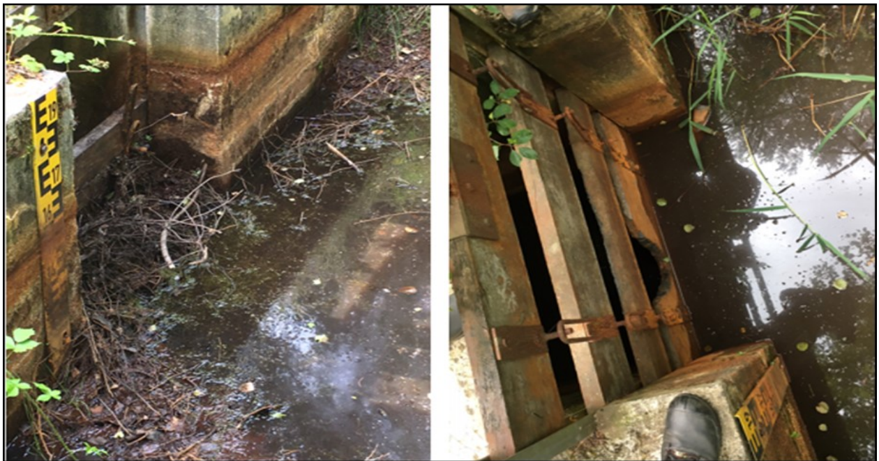
Abb 10: Defekte Wehre am Pegel P2 (linke Seite: fehlende Holzbretter im oberen Teil) sowie am Pegel P3 (rechte Seite: Loch im Brett sowie mehrere offene Elemente) (ECOSAX GmbH 2019)
