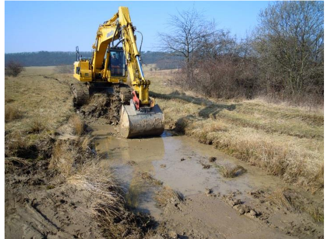
Foto 155: Wiederherstellung Rohboden und Nachverdichtung in Fahrspuren (15.03.2012)
