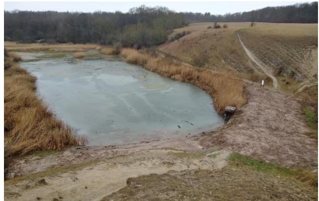
Foto 104: Ertüchtigung des gesackten Staudammes (03.02.2021)
