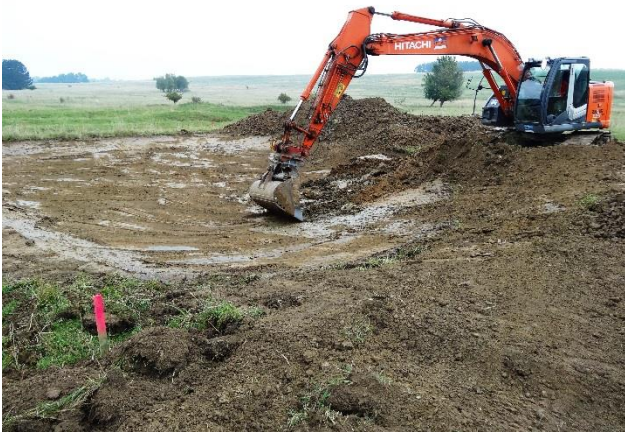
Foto 166: Anlage Tränke im Südwesten des Plangebiets (09.10.2013)
