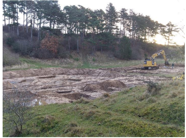
Foto 150: Anlage Senkenfeld südlich des oberen Teiches (11.12.2018)
