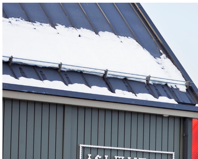
Mynd 6. Þakgrind (snjóhengjuvörn) með tveimur rörum á málplötuklæðningu í Bankastræti.
