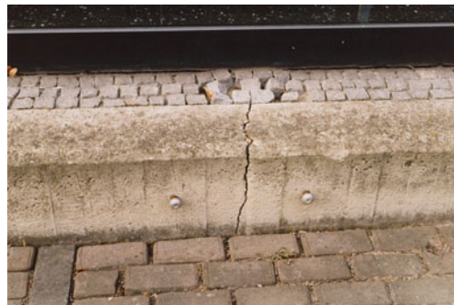
Abb. 10 Durch Bodensetzung gebrochener Bordstein mit Höhenmessbolzen
