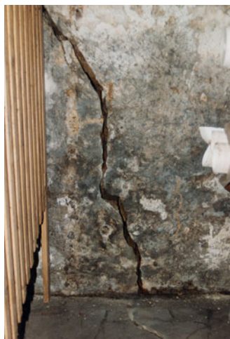
Abb. 9 Bergschaden: Kellerwand und -boden sind durchgerissen
