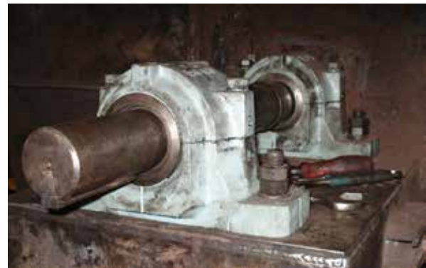
↑ Air Recirculation Fan
