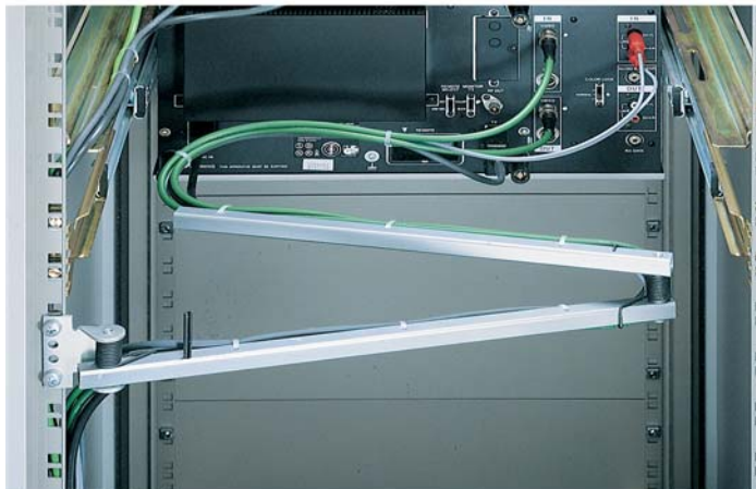
Kabelträger mit Rückholfeder
