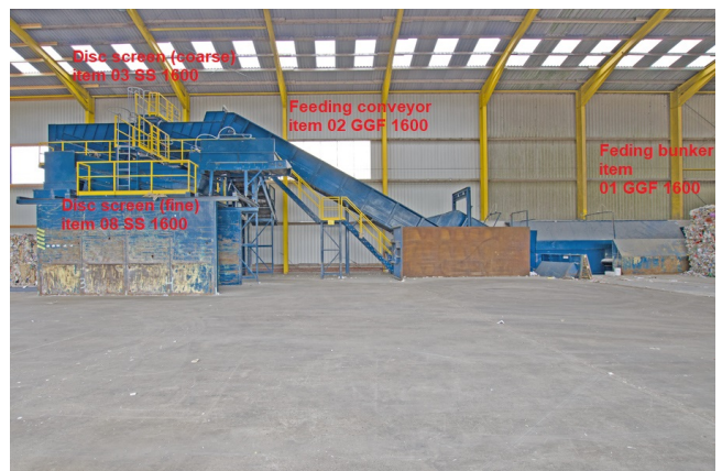
Seitenansicht, rechts Aufgabebereich, mitte Kettengurtförderer mit Dosierhaspel, links Scheibensieb, 3-stufig, für Grobsiebung.
