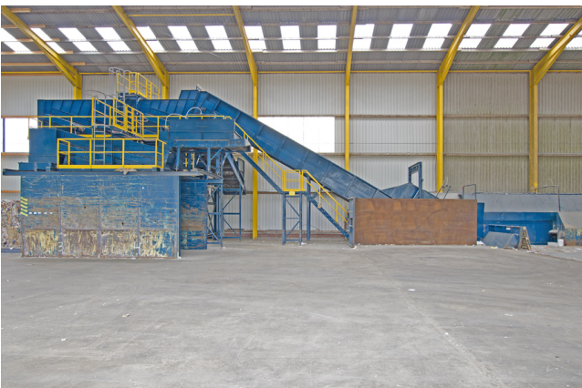
Seitenansicht, rechts Aufgabebereich, mitte Kettengurtt Förderer mit Dosierhaspel, links Scheibensieb (grob) mit davor befindlichen Scheibensieb (fein).
