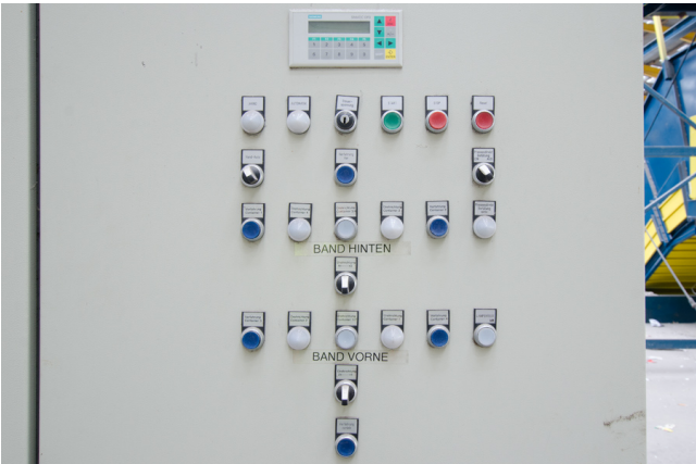
Steuerung der Fördertechnik der Containerverladestation.
