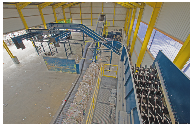
Übersicht, rechts drittes Deck vom Scheibensieb (Grob-Sieb) mitte und links Aufgabeband mit Beladestation für Container und Walking Floor LKW.
