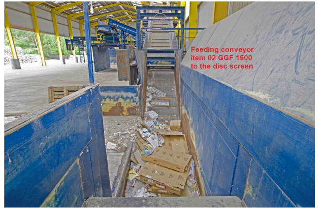
Ansicht vom oberflur Aufgabebunker auf das unterflur Aufgabeband (Kettengurtförderband Pos. 02 KGF 1600), mit Dosierhaspel.
