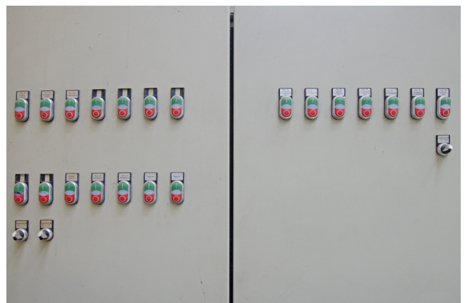
Steuerung der Fördertechnik und Scheibensiebe vor der Containerverladestation.
