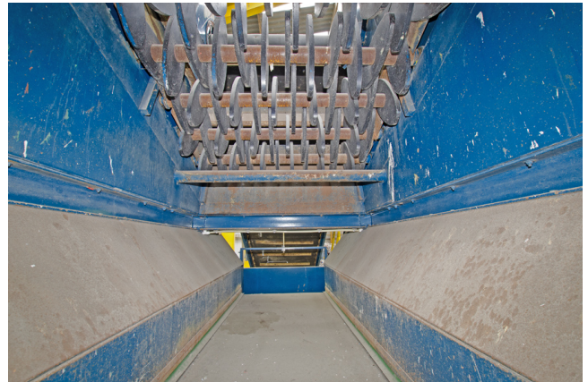
Austragsband Mittel- und Feinkorn, Pos. 05 GGF 1200, in Förderrichtung auf das 2. Austragsband (Querband, Pos. 06 GGF1200).
