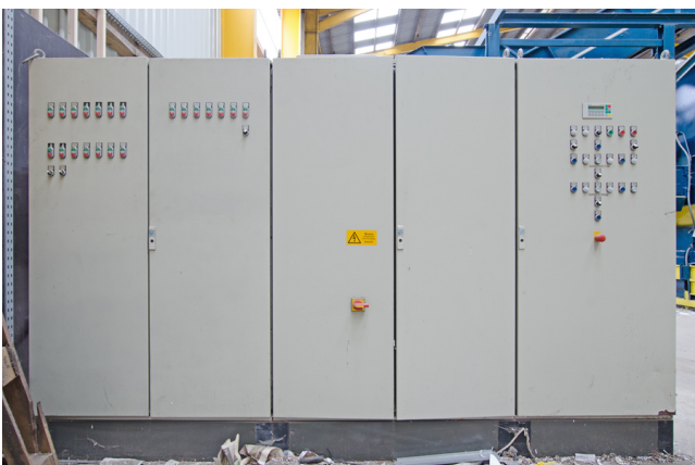
Hauptschaltschrank, fünfteilig, zur Steuerung der Gesamtanlage.
