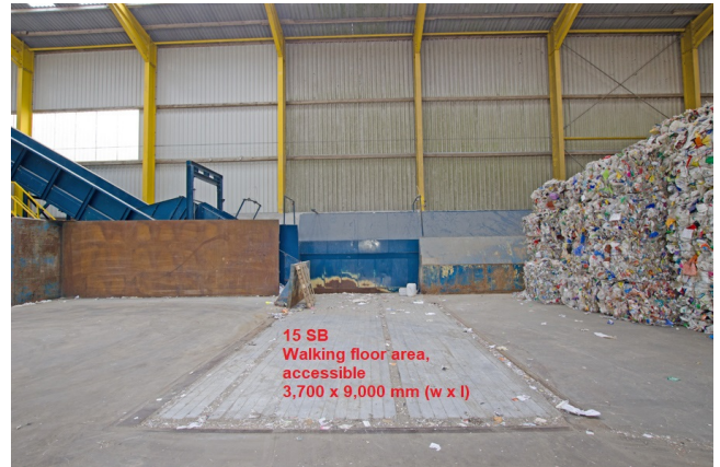
Aufgabebereich, links Prallwand für die Materiallagerung, mitte unterflur Schubboden 3.700 x 9.000 mm (B x L), rechts Prallwand vor dem Aufgabebunker.
