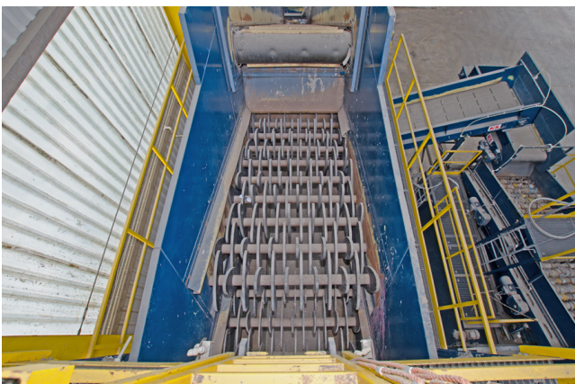
Draufsicht vom Wartungspodest auf das erste und zweite Deck vom Scheibensieb (Grob-Sieb), Pos. 03 SS 1600.
