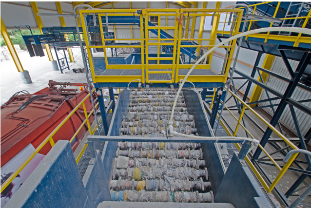
Ansicht erstes Deck Scheibensieb, Pos. 08 SS 1600 (Fein-Korn), mit darüber befindlicher Wartungsplattform.
