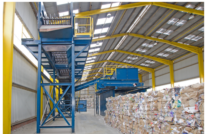
Ansicht Austrag zweites und drittes Deck Scheibensieb (grob), Pos. 06 SS 1600. Hier war die Fördertechnik mit der Sortierkabine installiert. Diese Anlagen sind nicht mehr verfügbar.
