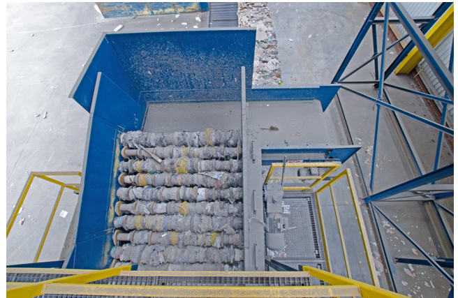
Ansicht zweites Deck des Scheibensiebes, Pos. 08 SS 1600, Austrag des Überkorns (Mittelkorn) auf das Querband Pos. 09 GGF 1200.
