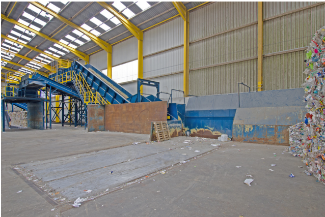
Abkipffläche mit Lager- und Aufgabebereich sowie Fördertechnik zum Scheibensieb (Grob-Sieb und Fein-Sieb).
