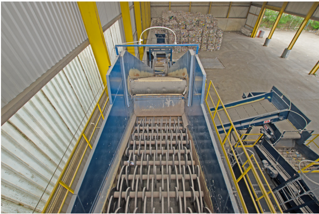
Draufsicht, erstes Deck vom Scheibensieb, Pos. 03 SS 1600, danach Steigband, Kettengurtförderer Pos. 02 KGF 1600, zum Aufgabebereich.
