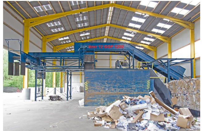
Seitenansicht automatische Beschickungsanlage für Container und Walking Floor LKW.
