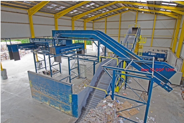
Ansicht Aufgabeband Pos. 12 GGF 1200, nach der Sortierkabine, zur automatischen Verladestation. Der Fördergurt ist defekt, demontiert und nicht mehr verfügbar.
