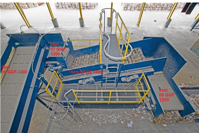
Draufsicht 2-stufiges Scheibensieb (Fein-Korn), Pos. 08 SS 1600, rechts davon das Austragsband für den Siebüberlauf, Pos. 09 GGF 1200.
