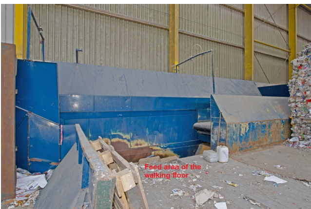
Materialaufgabe vom Schubboden zum unterflur Kettengurtförderband, rechts der oberflur Aufgabebunker.
