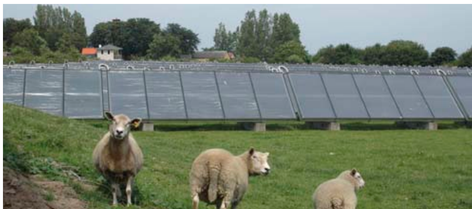
Verdens største solfangeranlæg
