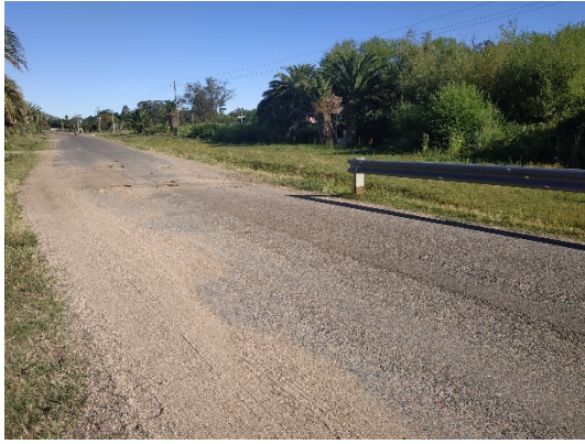
Vista de sección pavimentada (deteriorada y con baches) en Estación Las Flores
