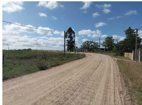
Curva cerrada con erosión incipiente por escurrimiento superficial
