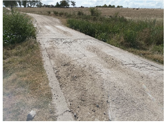
Badén con alcantarillas con deterioro en el pavimento
