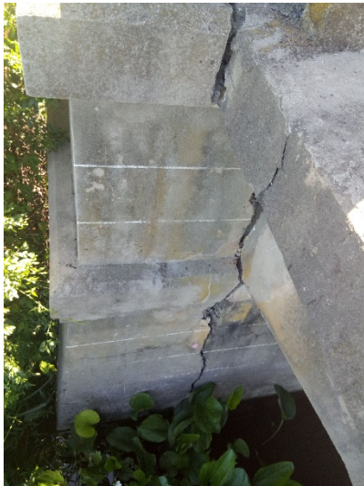
Fisura transversal en la cabecera este
