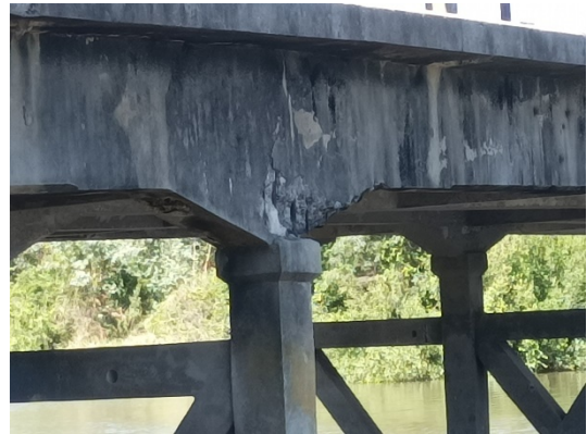
Vista del deterioro en pilares
