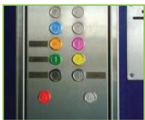
Pulsanti colorati per i nuovi ascensori
