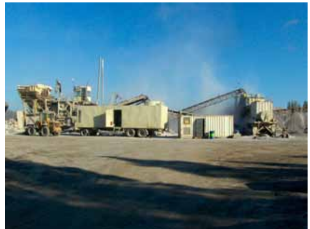
Murskaamo aiheuttaa melun lisäksi myös pölyhaittaa laitoksen välittömään läheisyyteen.
