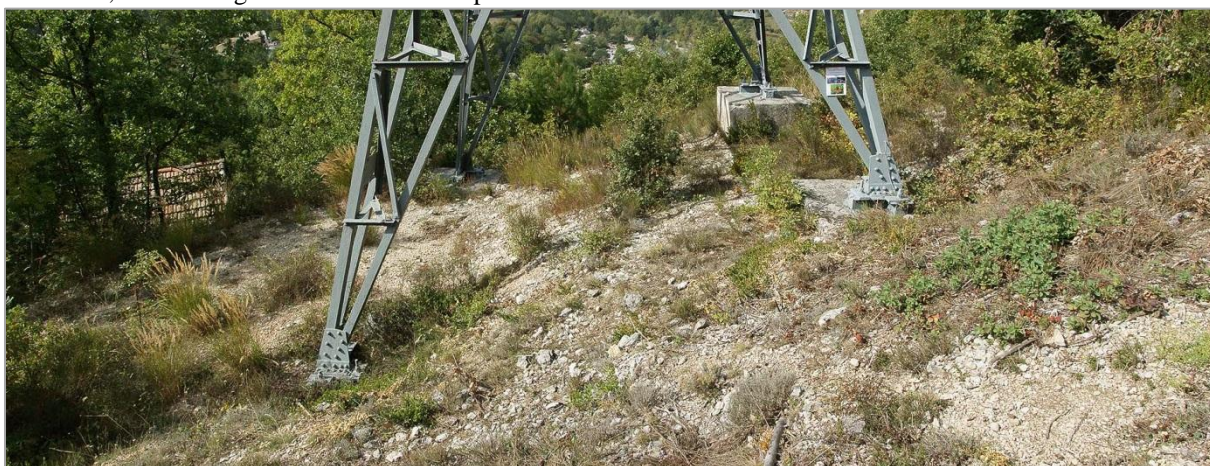
Vue rapprochée de la base du pylône 1, les pieds secs de Céphalaire à fleurs blanches ne se distinguent plus parmi la végétation.
